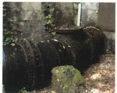
Sichtbare Teile der Druckleitung
