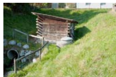
Quellfassung im Töbel
