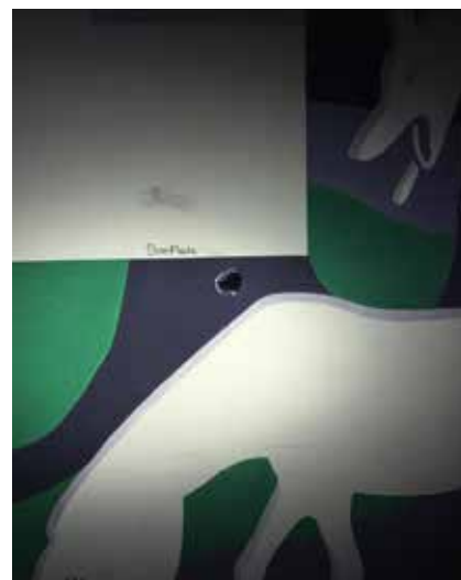
Beschädigte Fassade im Kindergarten Ausserdorf
