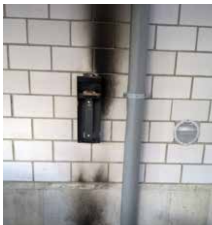
Beschädigter Aschenbecher bei der Toilettenanlage
